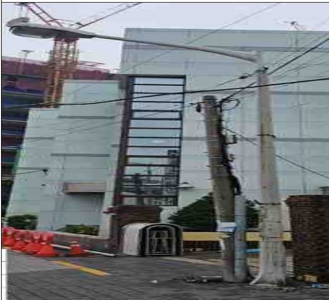
노후 가로등(FRP) 교체 전
