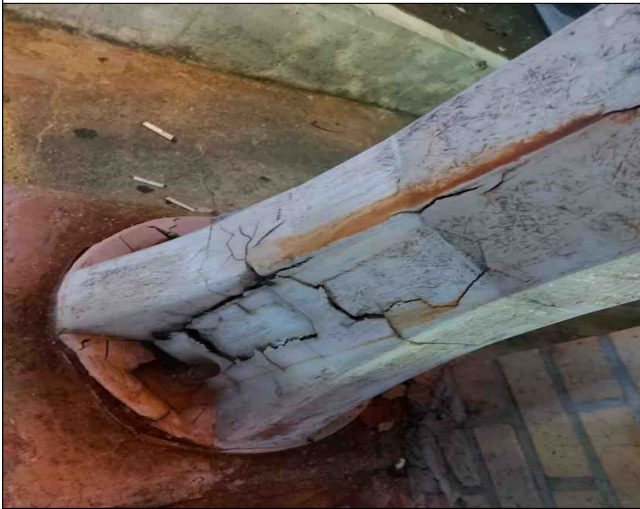
노후 가로등(FRP) 현장사진
