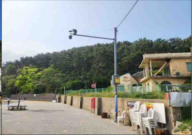
방범용 CCTV 신규 설치 후
